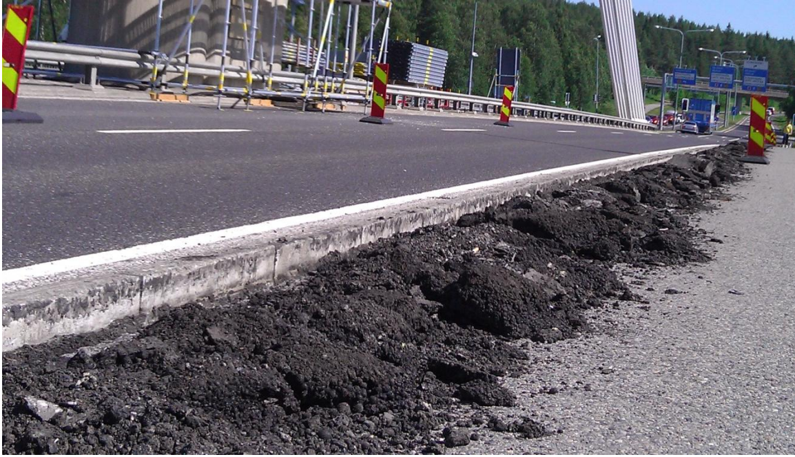
KUVA 8. Kuva on otettu Jätkänkynttilän sillalla. Lasten mielestä sillan korjaus tulisi saattaa päätökseen. Lisäksi lapset toivoivat, että kevyenliikenteen ja autokaistan väliin laitetaan aita.
